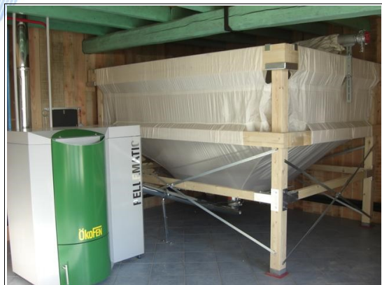
Chaudière et ballon + silo textile
