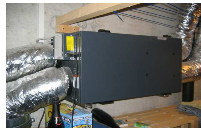
Caisson de VMC Double Flux installé dans une maison individuelle
