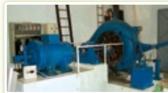
Génératrice et turbine
