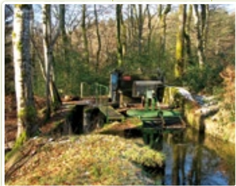
Dégrilleur et prise d'eau
